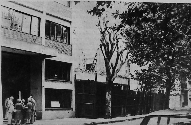
Vista parcial de la fachada de la Union General Armenia de Beneficencia donde se aprecia a la derecha los trabajos de demolición. El Presidente Vitalicio de UGAB Mundial
